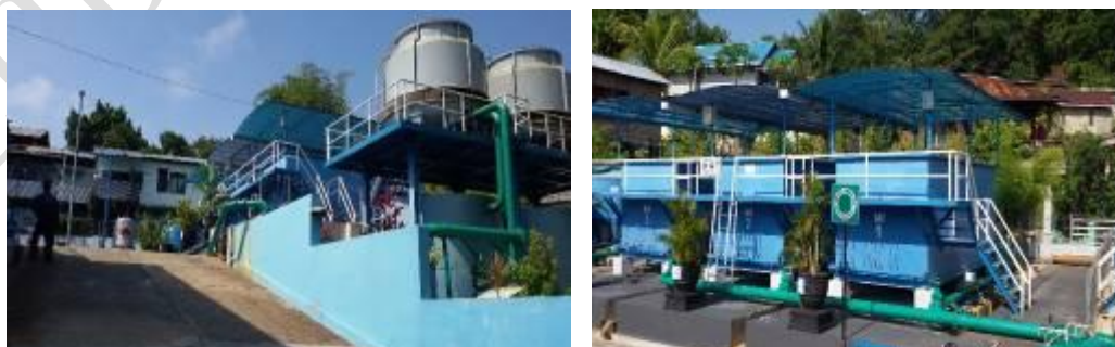
Gambar 3.23. Instalasi Pengolahan Air Prapatan
