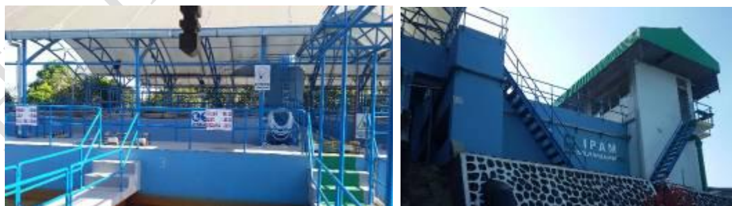
Gambar 3.20. Instalasi Pengolahan Air Manggar (KM.12)
